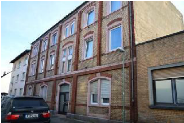
Gebäude mit leichten Mängel
