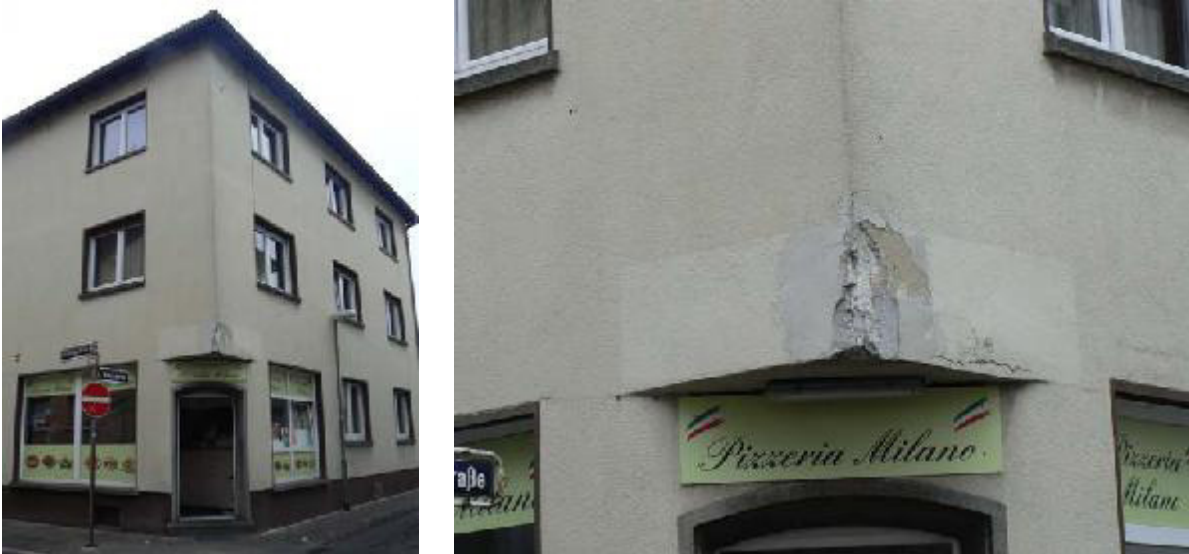
Schaden an Hausfassade (Fotos: Stadt Offenbach)
