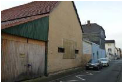
Scheune mit Sanierungsbedarf (Fotos: Stadt Offenbach)
